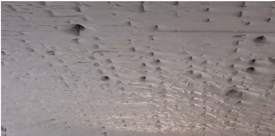
Bild 2: Silikagewölbe mit lokaler Korrosion (Fall B in Tabelle 1).
